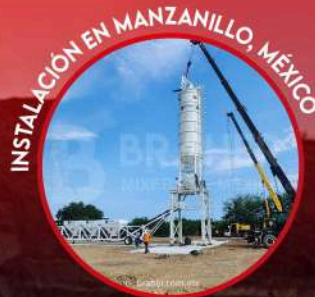
Silo de 80 toneladas seccionable + Planta dosificadora de 3 tolvas
