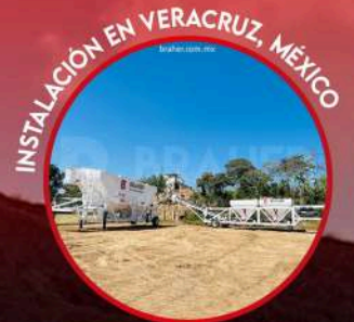
Silo móvil de 45 toneladas + Planta dosificadora de 2 tolvas
